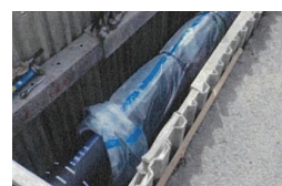
耐震化された水道管
